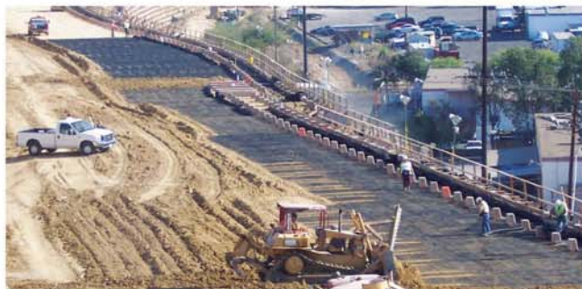
加利福尼亚圣迭哥的“Merge”项目正在进行的护墙及车道建设
